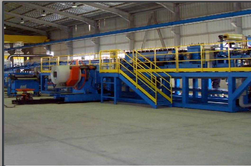
Vista generale parte iniziale macchina
