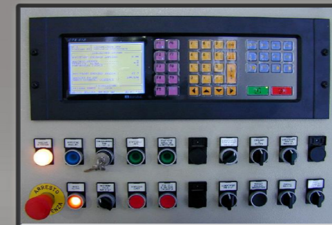
Pannello di controllo
